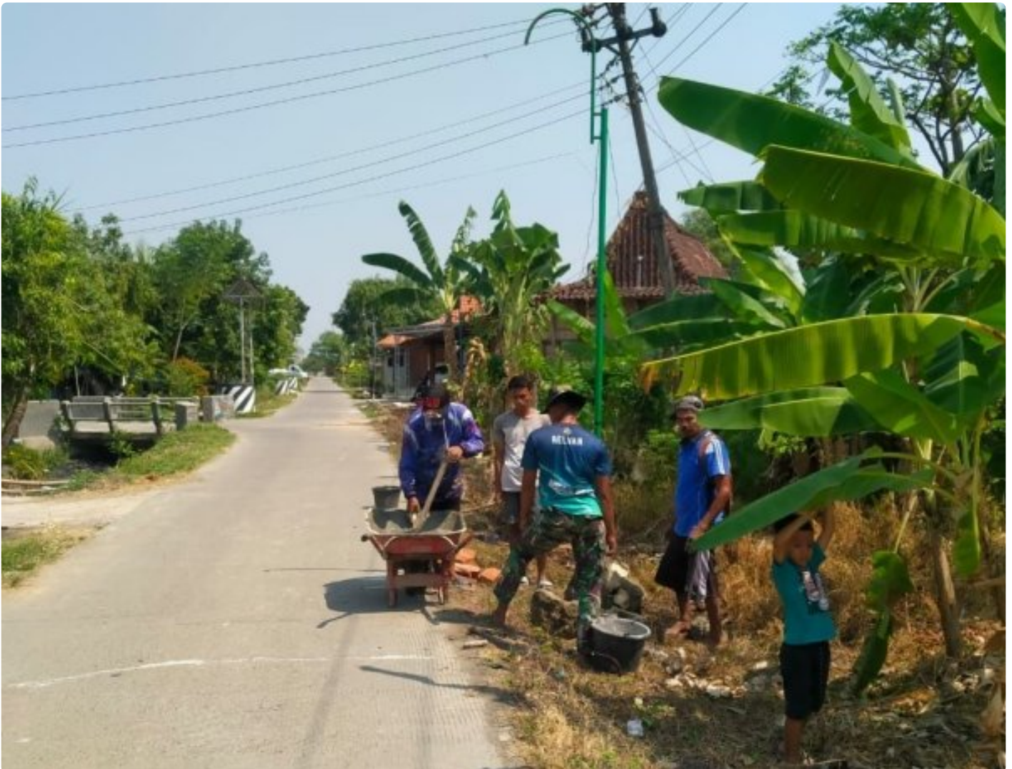
Satgas TMMD Reguler Ke-117 Kodim 0717/Grobogan Perbaiki Tiang Lampu Penerangan Jalan Di Desa Cangkring
